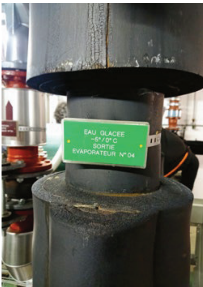
Conduite d'eau glacée. Cave d'Agroscope-Changins. Photo : Agridea.
